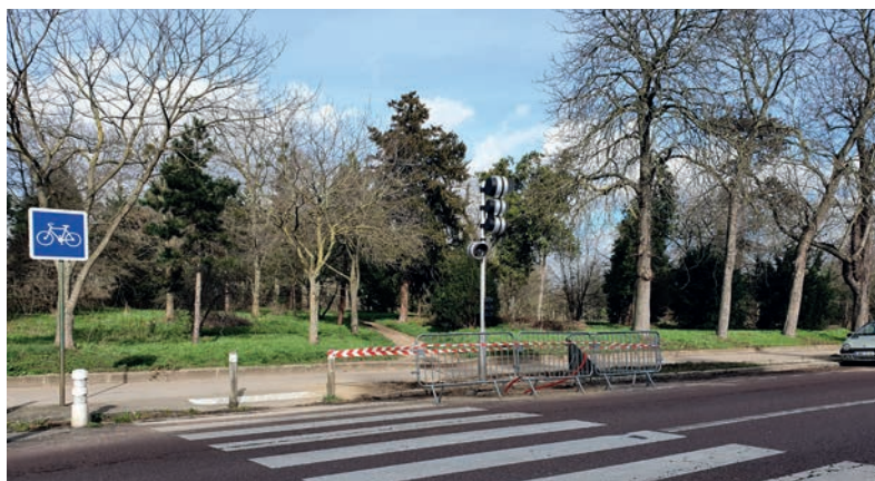
La société ENGIE a procédé sur le carrefour avenue de Gravelle - rue Guérin et celui situé au croisement de l'avenue de Gravelle - rue Jean Jaurès au positionnement du feu préparatoire à la pose du feu récompense.
